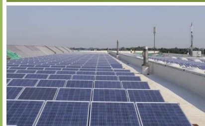
755 kWp-PV-Anlage, Fa. Aumund
